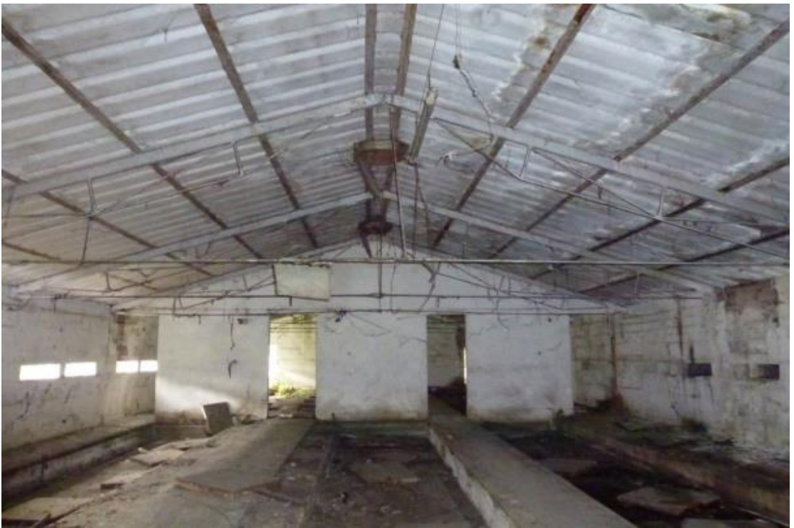
Figura 2 - Sito produttivo con coperture da bonificare.
