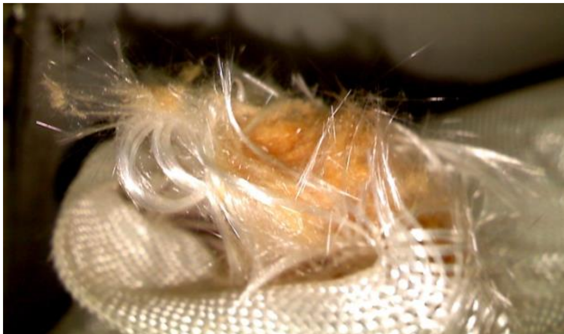
Figura 3 – Cordino isolante in fibra di amianto
